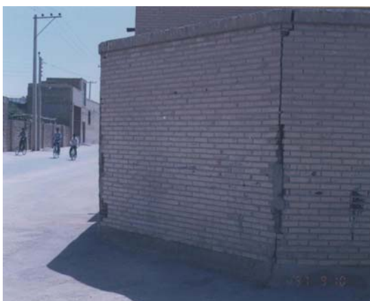
شکل 3. جابه‌جایی نسبی قسمتهای مختلف دیوار حیاط نسبت به هم و ایجاد گسیختگی در محلهای تمرکز تنش (شهرک امام جعفر صادق)
